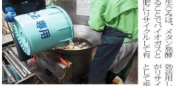
大木町による資源循環 生ごみメタン発酵設備
