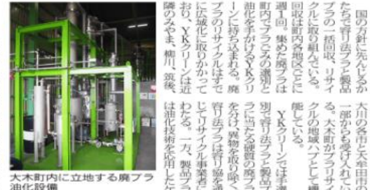
大木町内に立地する廃プラ油化設備
