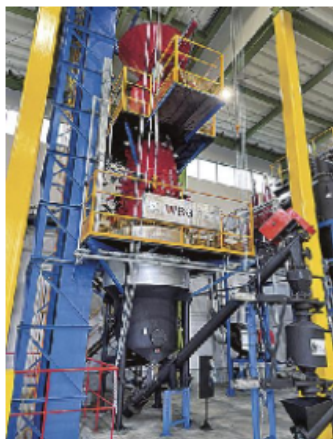
バイオマスガス化炉の外観
