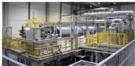
旭化成が福島県で稼働中の世界最大級の大型アルカリ水電解システム
