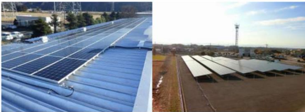
【当社グループにおける太陽光発電の導入事例（左：東北工場、右：中津工場）】
