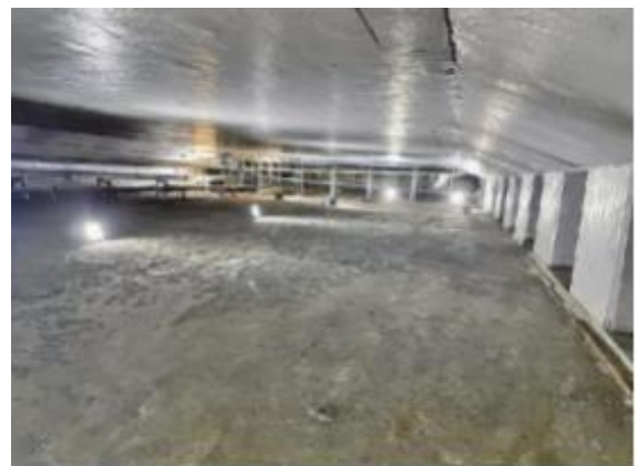
劣化が進行する中床版
