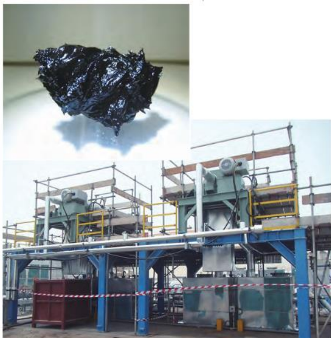
スラッジ（上）と遠 心分離設備
