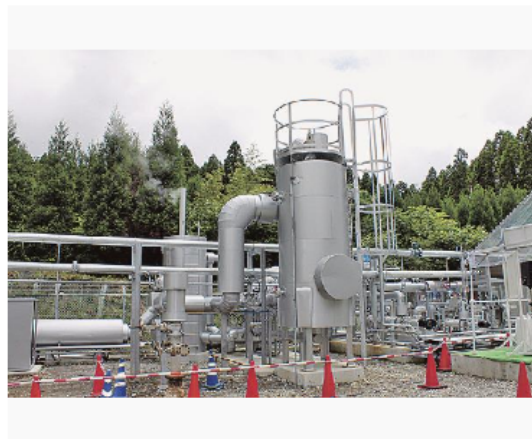
大分県九重町に建設した大林組の実証プラント(21年7月撮影)
