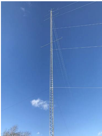
北海道製油所では敷地内で風況観測塔の運用を始めた
