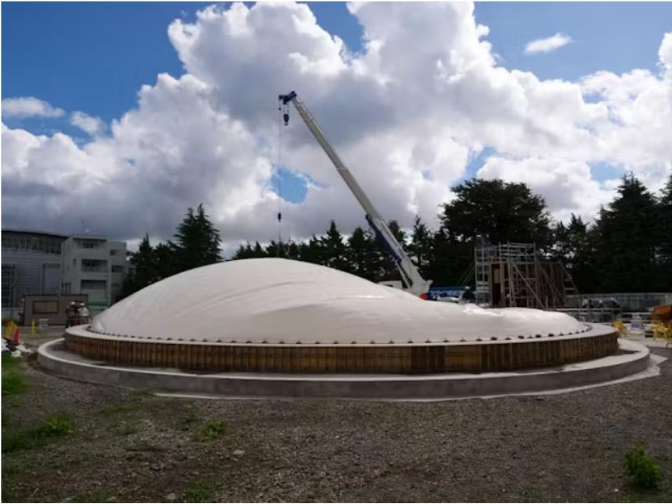
試験施工中のCUCO-SUICOMドーム。ドーム型のポリ塩化ビニール（PVC）膜を送風機で膨らませ、これを型枠として内側に配筋する。PVC膜は国内で工場製作したものを使う（写真:鹿島）
