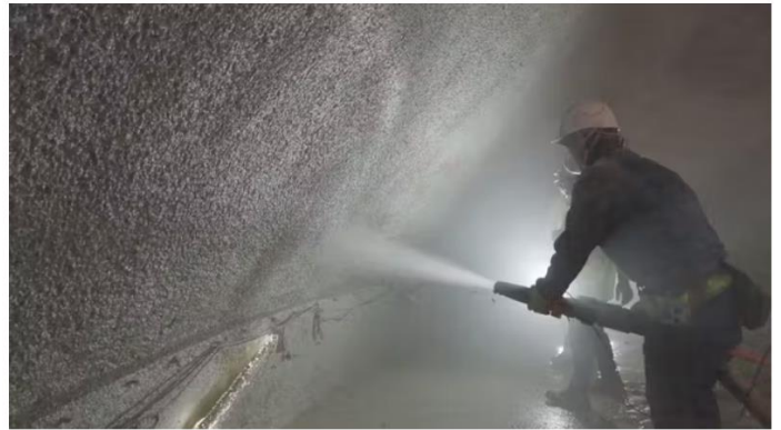
ECMコンクリート、CUCO-SUICOMショットの順でコンクリートを吹き付ける。PVC膜の内部で施工を進めるため、天候の影響を受けにくい（写真:鹿島）
