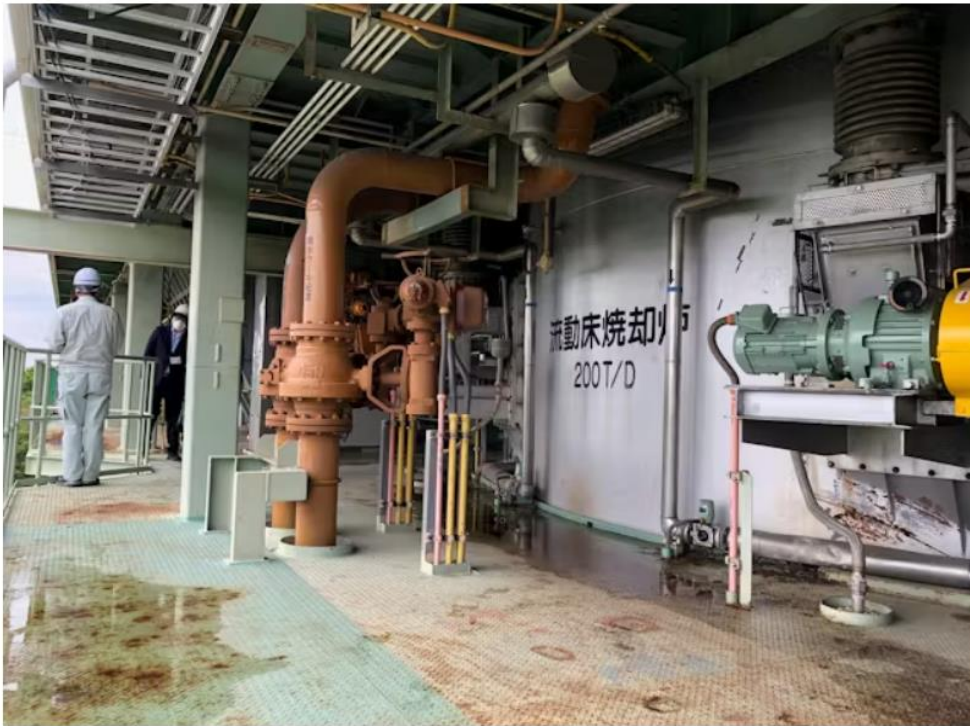
下水汚泥を燃焼させる設備（埼玉県戸田市の荒川水循環センター）
