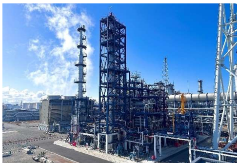
大阪府堺市にある SAF 製造設備。
