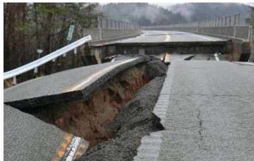
崩壊した能登大橋の取り付け部(写真:国土交通省)
