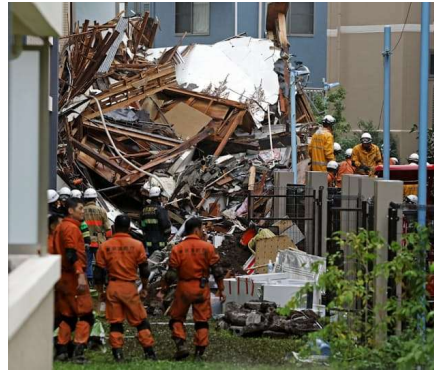
木造 2 階建ての住宅が倒壊した現場で作業をする消防隊員ら(東京都杉並区)=共同
