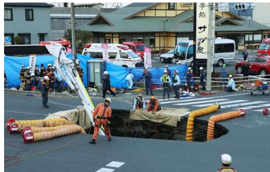
埼玉県八潮市の道路陥没で、転落した車両の運転手の救助活動に当たる消防隊員ら（1 月、埼玉県八潮市）
