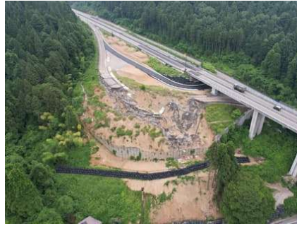
地震で損壊した穴水 IC 付近。崩壊した盛り土に集水枡を設置する(国交省提供、24 年 7 月時点)
