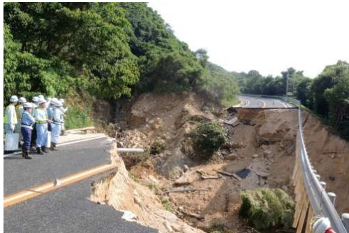
2018 年の西日本豪雨における NEXCO 西日本管内の広島呉道路の被災箇所。写真左手で土石流が発生した(写真:日経クロステック)
