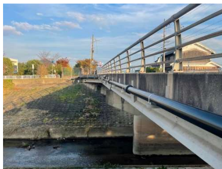
会計検査院の検査で、耐震性不足の恐れがあることが分かった奈良県田原本町の橋梁。添架水管橋が付いている
