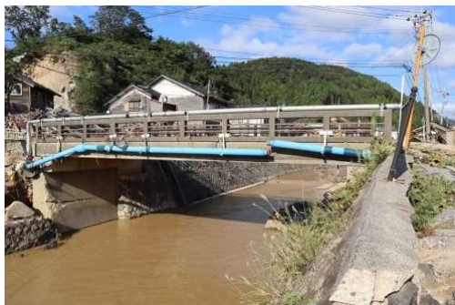
2024 年 1 月の能登半島地震で損傷したと見られる水管橋(写真:日経クロステック)
